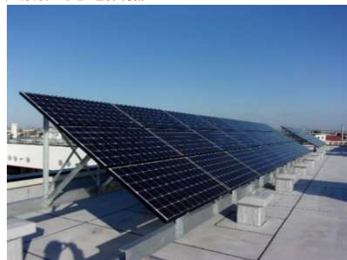
太陽光発電設備
