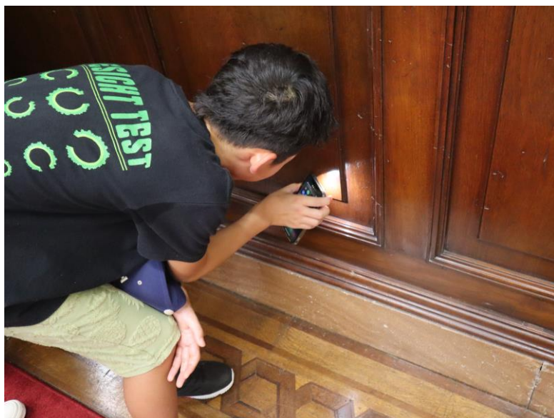
旧日本銀行広島支店 ガラス片や傷跡が残った壁
