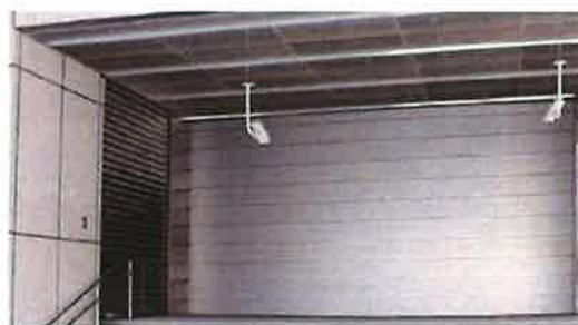
防水シャッター
