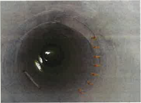
久領堤雨水貯留管 (貯留量 約10,000㎡)
