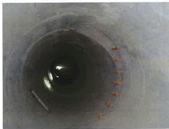
久領堤雨水貯留管 (管径 \phi 2.6m 貯留量 約 10,000 m 3 )
