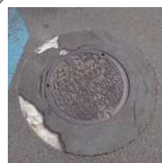
マンホールがガタついている。
