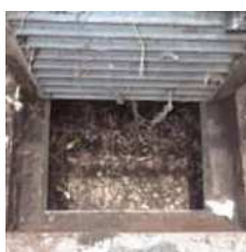
集水樹内に土砂が堆積している。
