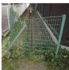
転落防止柵が壊れている。
