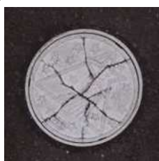
公共樹のフタが割れている。
