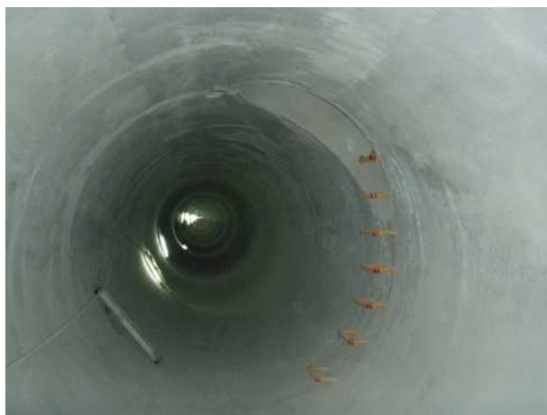
久領堤雨水貯留管 (管径 2.6m 貯留量 約 10,000 m 3 )
