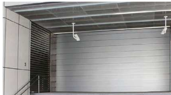
防水シャッター
