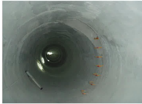
久領堤雨水貯留管 (貯留量 約10,000m 3 )
