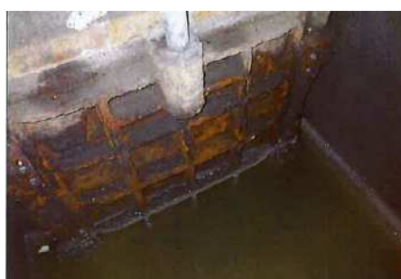
汚水流入ゲートの腐食状況
