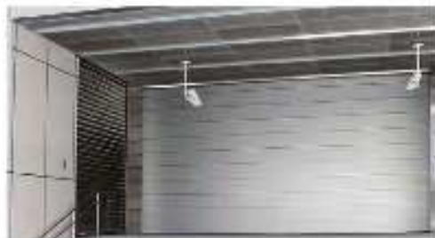
防水シャッター
