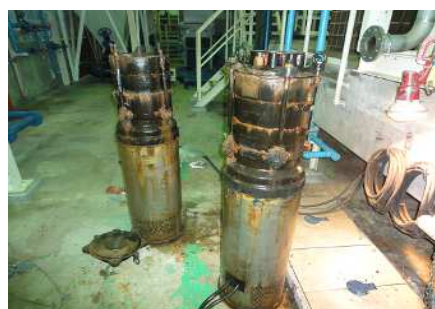
集砂ポンプの腐食
