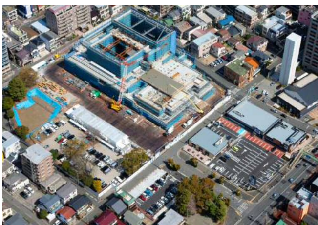
③民間収益施設のオープン 文化芸術ホールの大ホール鉄骨工事
