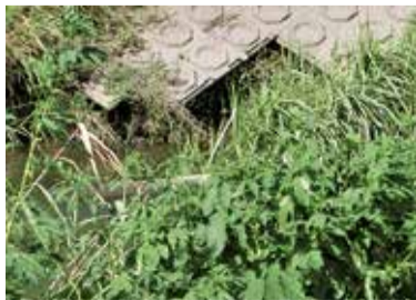
渋田川護岸崩落の様子
