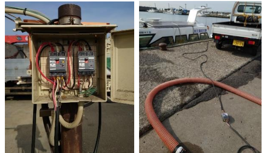
(荷捌き施設配電盤と電池推進船への給電用配線)
