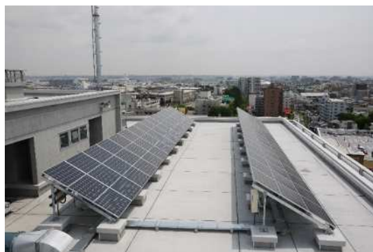
市庁舎本館の太陽光パネル
