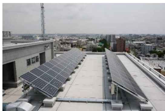
市庁舎本館の太陽光パネル
