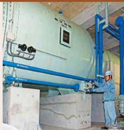
雨水ポンプは直径2.5メートル近い太さがあります
