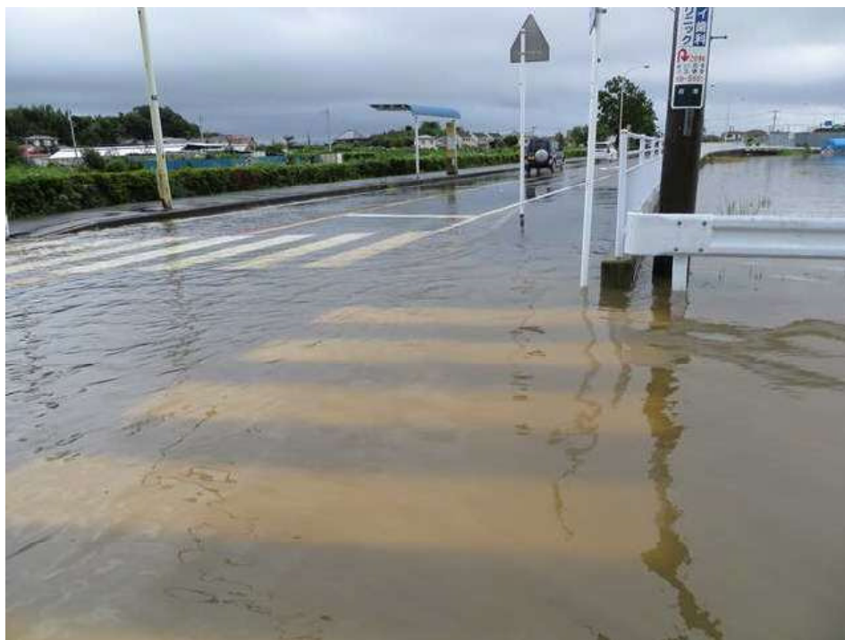
道路冠水の状況
