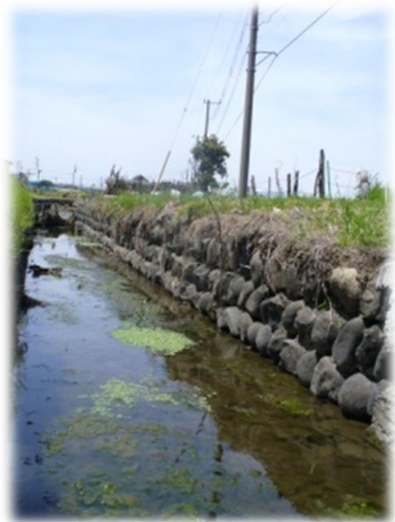
玉石を使用し周辺の自然環境との調和に配慮した水路
