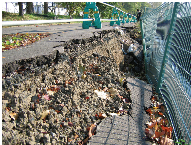
地震による道路被害
